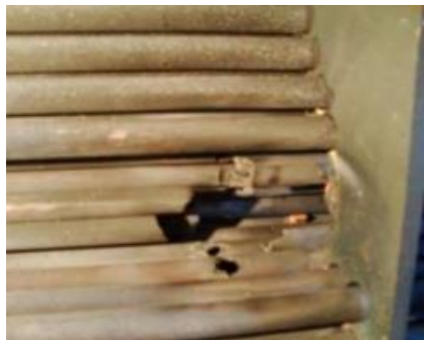
Gambar 2. Tube yang patah akibat kebocoran [10]
