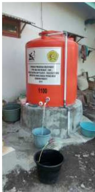
Gambar 6. Tandon Air yang Dipasang di Lokasi
