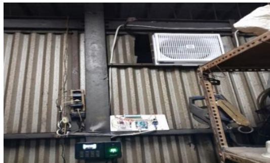
Gambar 14. Implementasi alat pada ruangan
